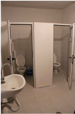
Toiletten mit fliessend Wasser
